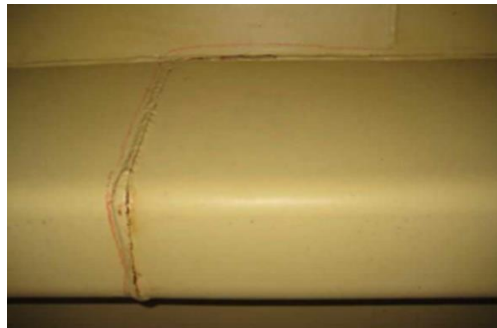
Gerissene Schweißnaht am Längsrippenstoß
