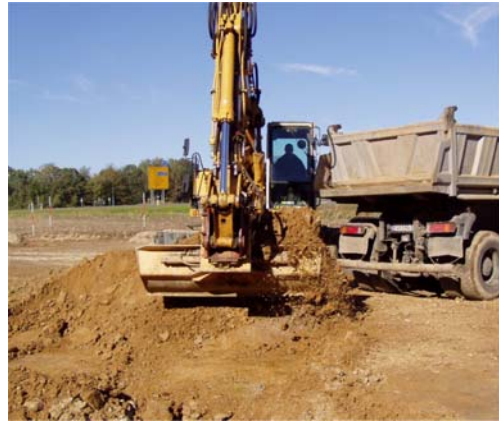
Gewinnung leicht plastischen Bodens für den Einbau als Rekultivierungsschicht auf einem Probefeld
