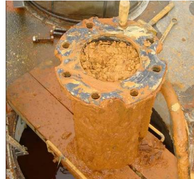
Verockerte Steigleitung eines Brunnens
