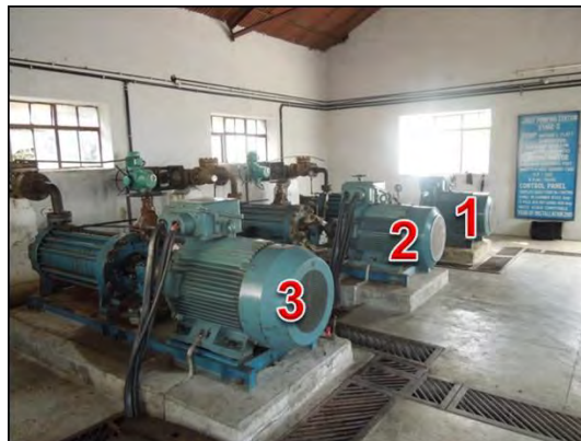
Pumpstation Jinsi II, Mussoorie, Indien
