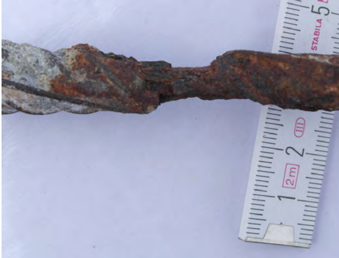
Abb. 2 Aus einem Bauteil gewonnener Bewehrungsstahl, der bereits durch chloridinduzierte Korrosion stark querschnittsgeschwächt ist.
