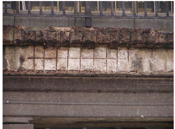
Abb. 1 Betonabplatzung durch korrodierte Bewehrung an einer Brückenkappe
