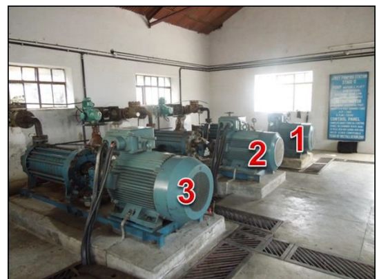
Pumpstation Jinsi II, Mussoorie, Indien
