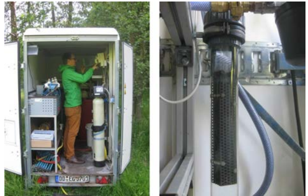
Versuchsanlage (links) und Elektrolysezelle (rechts)
