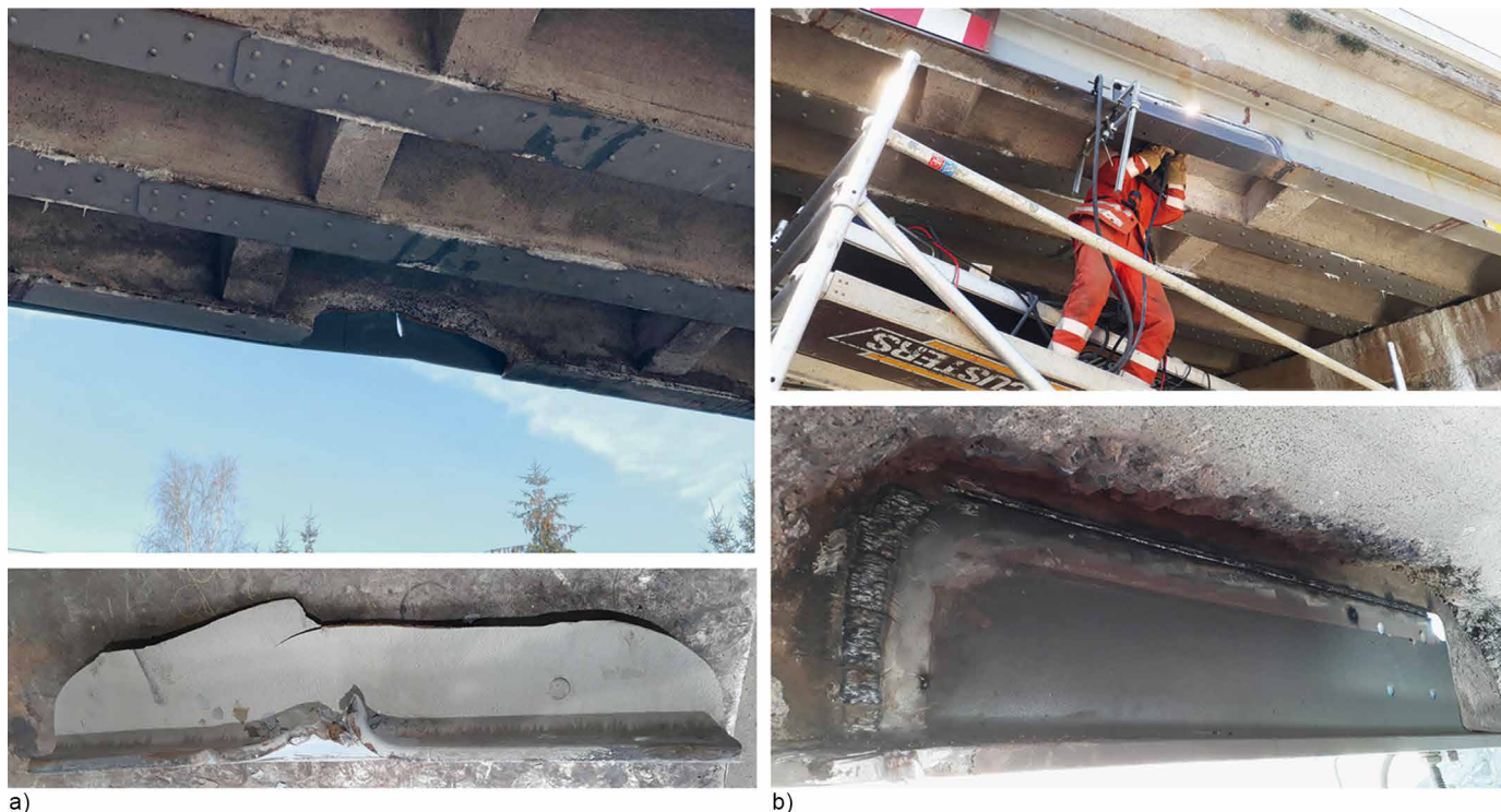
Bild 15 a) Geschädigter Randträger nach Anprall, b) Reparatur durch Einschweißen eines neuen Trägerstücks a) Damaged edge beam after impact, b) repair by welding in a new beam piece
