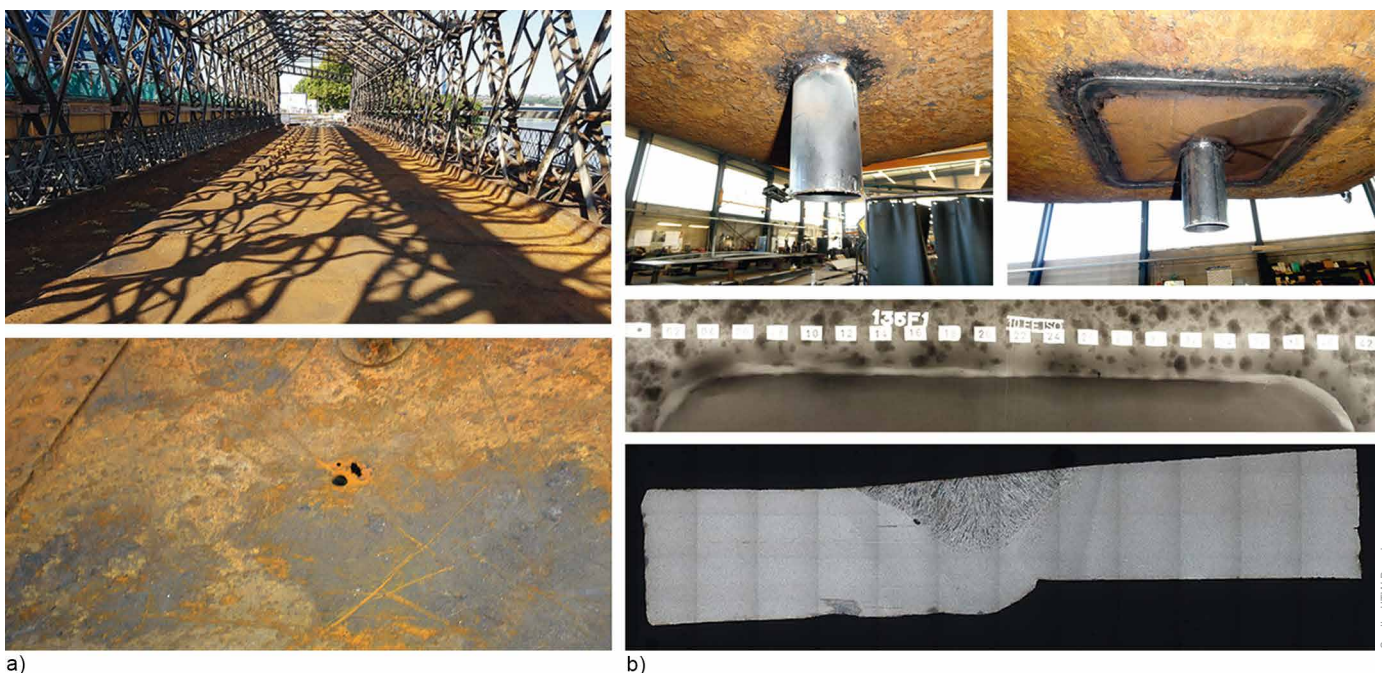
Bild 14 a) Brücke mit geschädigten Buckelblechen, b) neu eingeschweißte Tropftüllen a) Bridge with corroded buckled plates, b) newly welded drainage pipes
