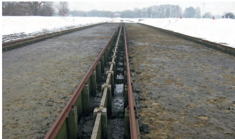
Becken mit Schienen und Zulaufrinne zur Beschickung der Becken.
