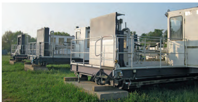
Vor dem Hochwasser 2013 gesicherte KUROF-Geräte im April 2014.
