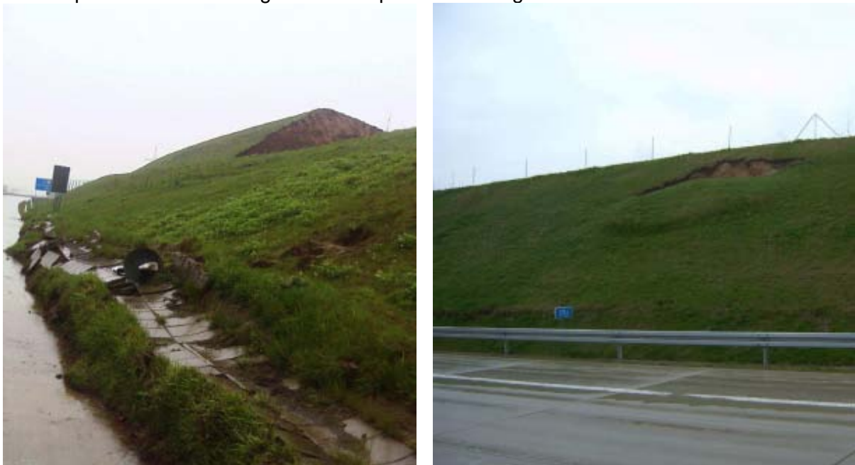
Abbildung 6: Böschungsrutschungen an Lärmschutzdämmen neben der Bundesautobahn
